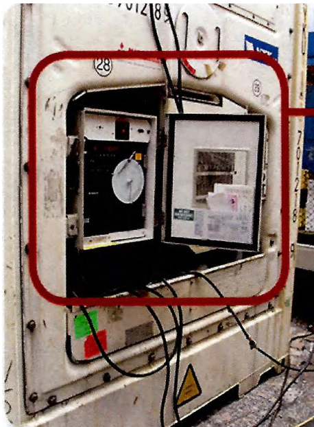
Sistema de enfriamiento
