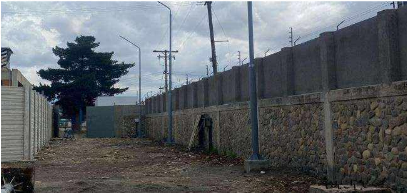
Mejoramiento de áreas de circulación (enlosetado) sector Archivos Aduana Interior La Paz Monto: Bs. 200.000
