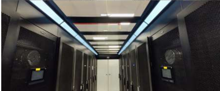
GABINETES DISTRIBUIDOS CORRECTAMENTE PASILLO FRIO – PASILLO CALIENTE
