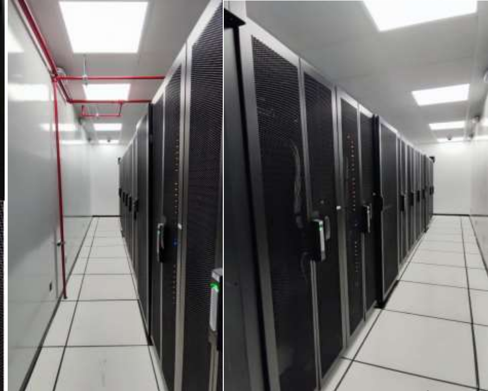
CABLEADO ESTRUCTURADO DE DATOS Y ENERGÍA CORRECTAMENTE DISTRIBUIDOS
